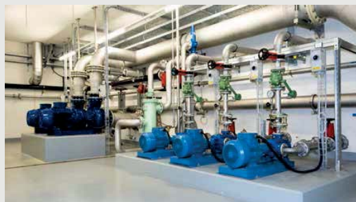
Pumpenraum der Filtration.
